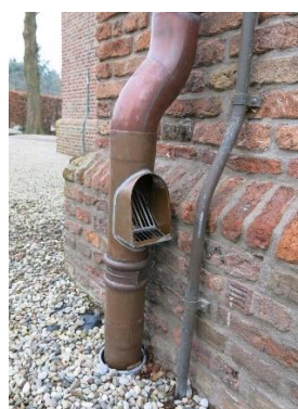
Open afvoer met bladscheider, regelmatig schoonmaken.
