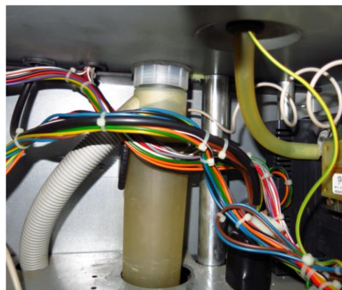
Foto hierboven: sifon voor afvoer condenswater.
